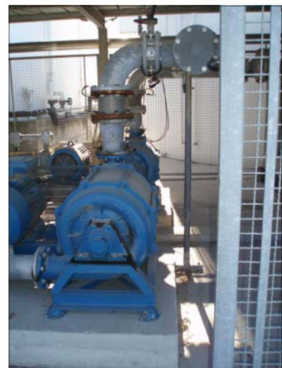
Sistema di aspirazione del biogas
